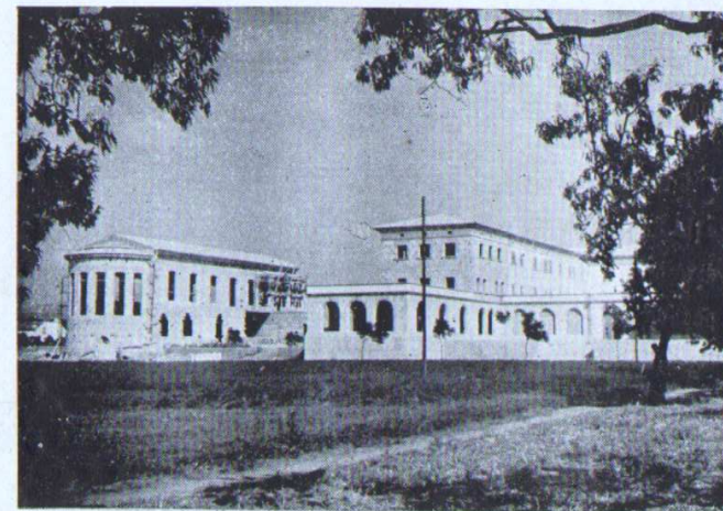
Vista general del estado de las obras de la Capilla y último Pabellón del Seminario.
